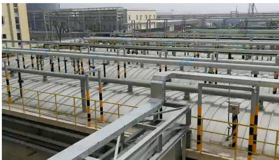
图 3.1.5-3 已建一期工程项目污水处理站
